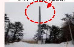
＜風車の羽根の脱落＞
