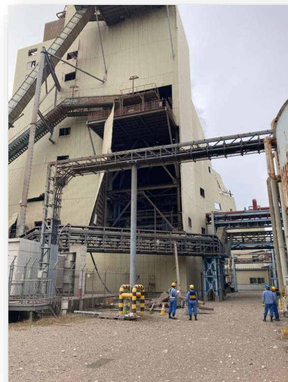
【破損状況写真】
