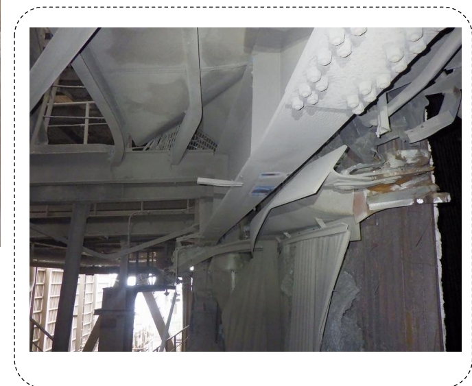
梁の変形状況(代表部)
