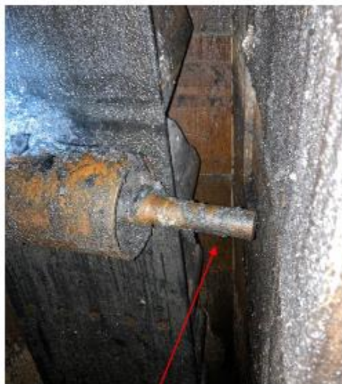
プーリーが外れている
