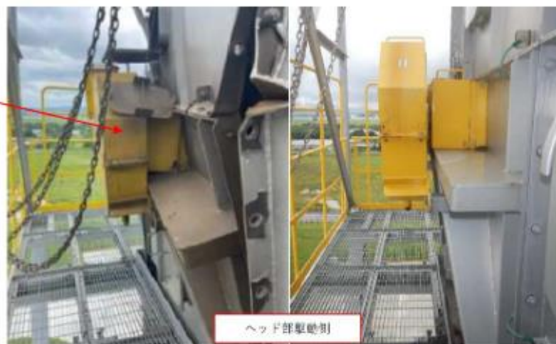
B側（損壊側）
