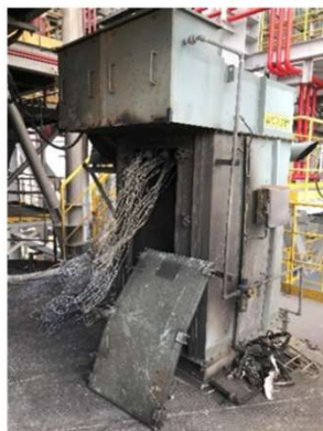
A-WPサービスバンカー集塵装置損傷
