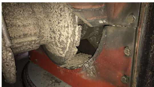
燃料落口状況
