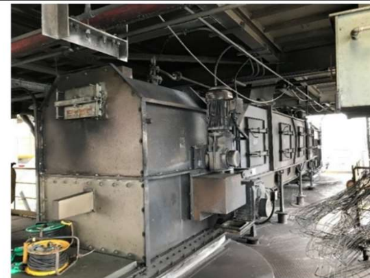
ケーシング変形
