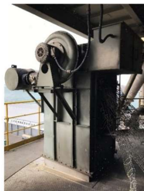
PKS/WPサービスバンカー集塵装置損傷
