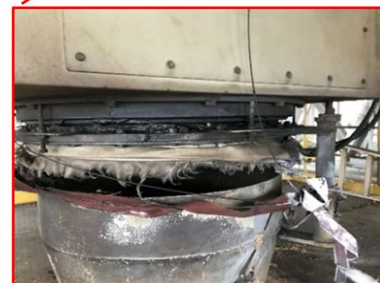
B-WPサービスバンカー払出装置 布製伸縮継手損傷
