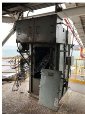
B-WPサービスバンカー集塵装置損傷
