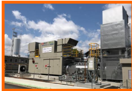
神戸CGS エネルギーセンター
