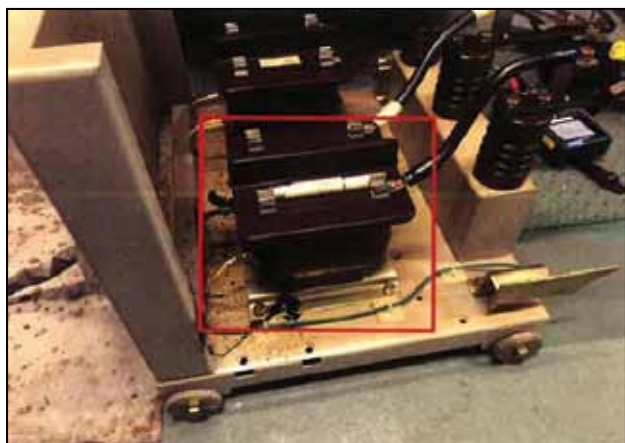
焼損した VT (計器用変成器) の側面
