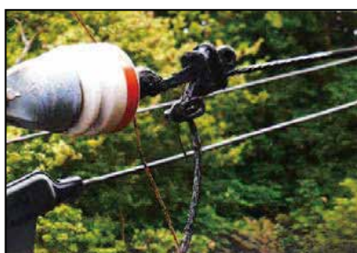
焼損した引留碍子 ※ツタの一部が接触、炭化 している
