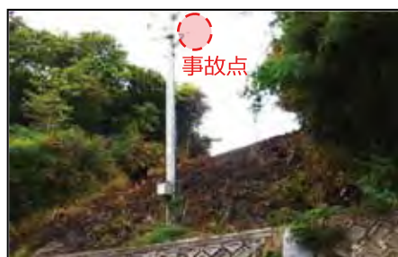
焼損箇所（遠景） ※約 5m 高さの擁壁上に コンクリート柱が設置されている
