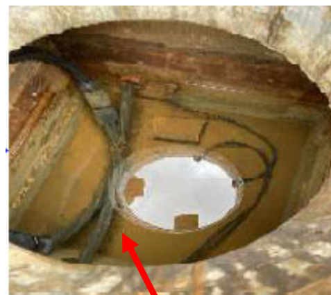
水に浸った高圧ケーブル
