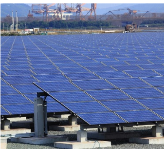
太陽光発電所
