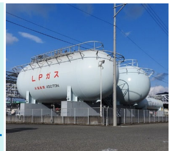
LPガス充てん設備（400t貯槽）
