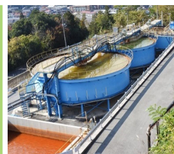
休廃止鉱山坑廃水処理施設
